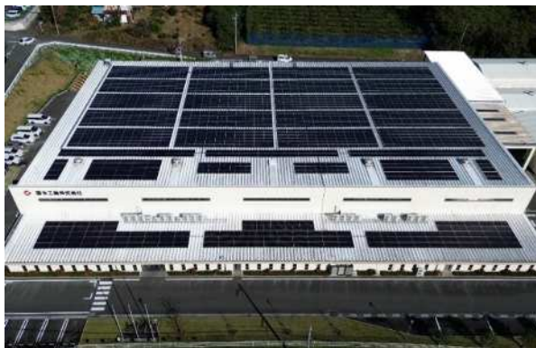
太陽光発電設備
