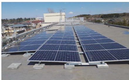
学校屋上に設置した太陽光パネル
