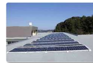
▲太陽光発電設備整備事業
