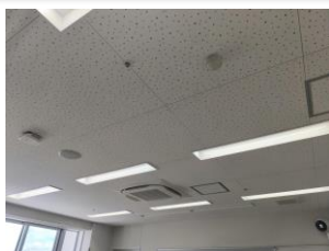
普通教室の空調室内機とLED
