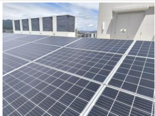
太陽光発電設備
