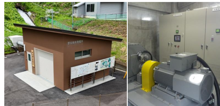
令和7年度充当予定事業：芋川用水発電所（長野県飯綱町 R7.5.23稼働）
