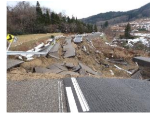
崩落した国道359号（小矢部市）
