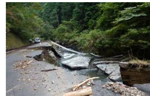
農道具伏宝ノ窪線の崩土被害
