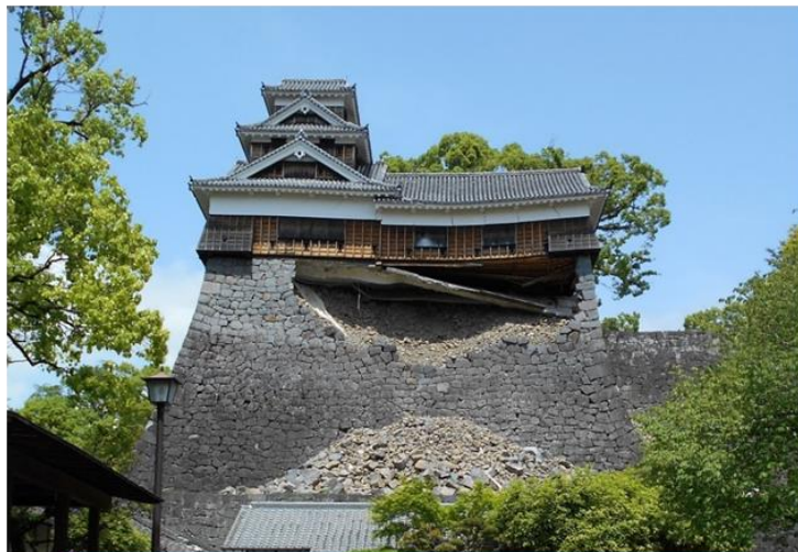
2016年4月22日 飯田丸五階櫓被災状況
