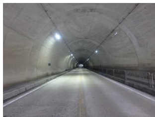
森本トンネルLED化(豊岡市)
