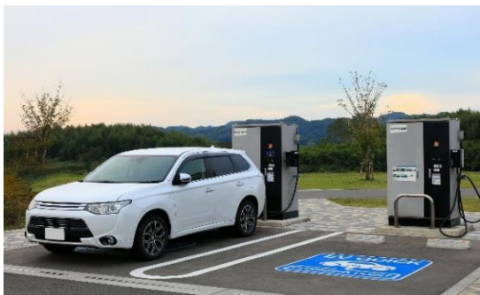
電気自動車と充電ステーション
