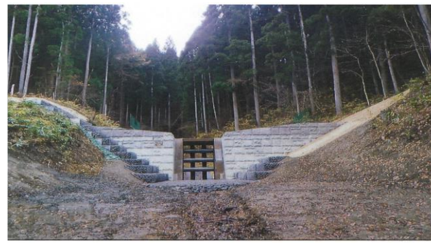
【通常砂防事業】 気候変動に伴う土石流被害の 軽減を図る砂防堰堤等の整備
