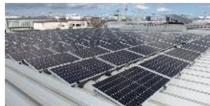
工場への屋根等未利用地を活用した需給一体型大規模太陽光発電の大量導入（地域と共生した再エネモデル）
