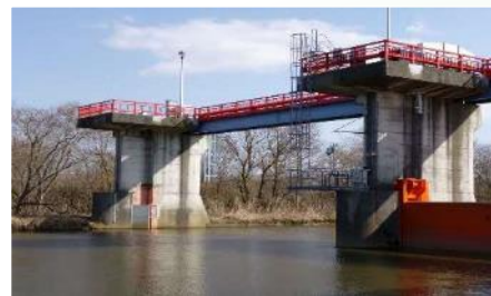
苫小牧地区工業用水道第二施設
