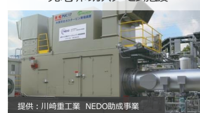
発電所のガスタービン施設
