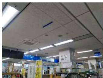
▲川崎区役所2F窓口 LED設置後
