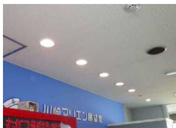
▲川崎マリエン展望室 LED設置後
