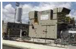
水素による熱電供給システム 川崎重工業(株)提供
