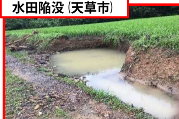
水田陥没（天草市）
