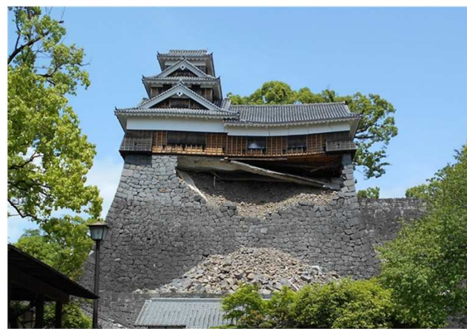
2016年4月22日 飯田丸五階櫓被災状況
