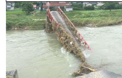
迫田橋(安佐北区)落橋
