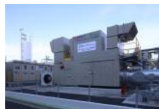
発電所のガスタービン施設(イメージ)
