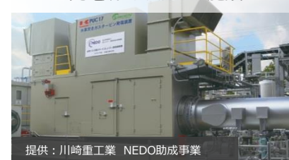
発電所のカスタム施設
