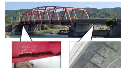
銅材の腐食 コンクリートの剥離 御坊由良線 由良港橋（由良町）
