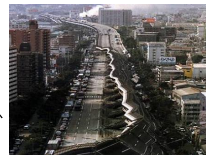
倒壊した阪神高速道路
