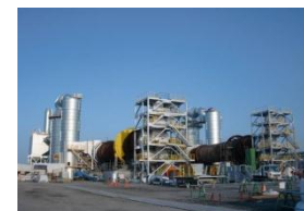
焼却炉の設置状況 【石巻ブロック】
